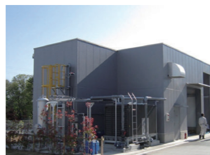
東京工場水処理設備
